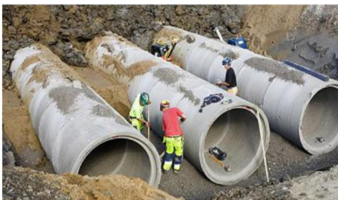
Figur 18. Bilden visar ett rörmagasin i betong.
