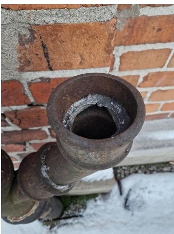
Figur 4. I byggnaden noterades blydiktade avloppsrör.
